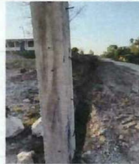
Foto 4: continuacion de columnas de muro perimetral por que corren peligro de los estudiante con la pavimentacion local.
