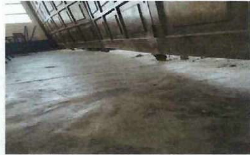
Foto 2: cabio de rodamiento del division de la Escuela.
